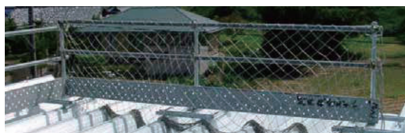
防護工用支柱
